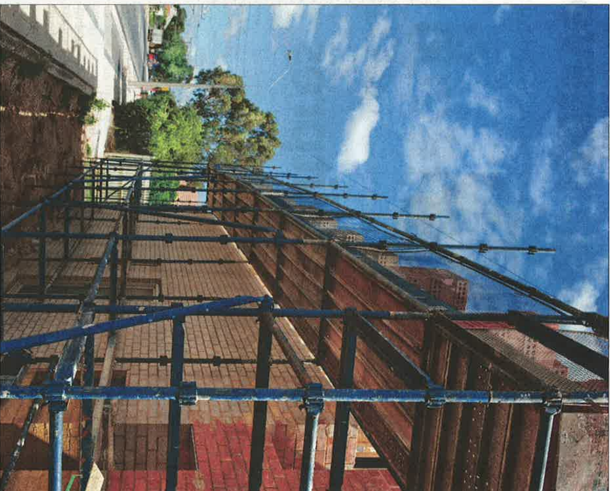
FA Stillads giver udsatte unge en billet ud af systemet, siger Anders Hjorth Jensen, konsulent for stilladsfaget i Dansk Byggeri. Genrefoto: Colourbox.
